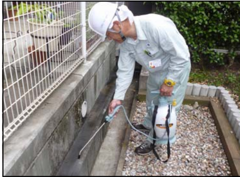
分譲団地・雨水排水溝-忌避剤散布（東京都内）
