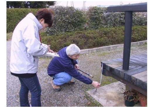
調書4:劣化等状況写真
