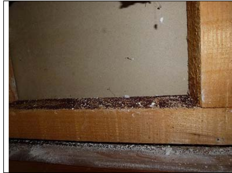
No. 10 リビング側壁下 糞及び被害状況
