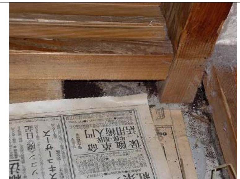
No. 8 リビング側襖 敷居下糞害状況
