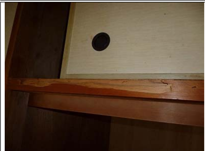
No. 3 押入れ天袋 敷居被害状況 1
