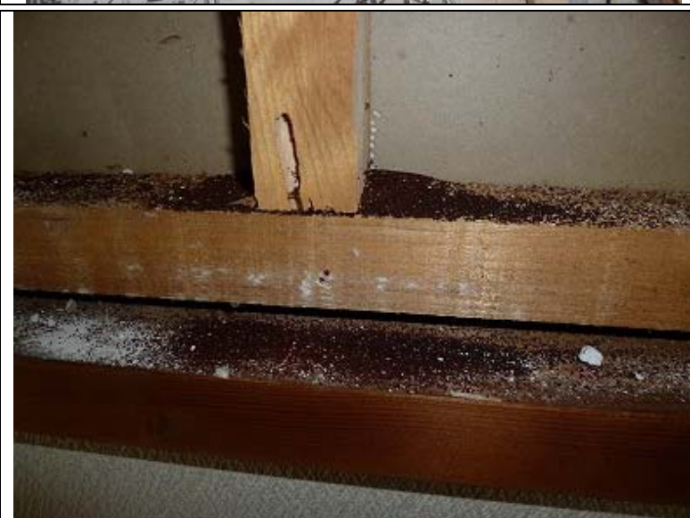
No. 9 リビング側壁下 糞及び被害状況
