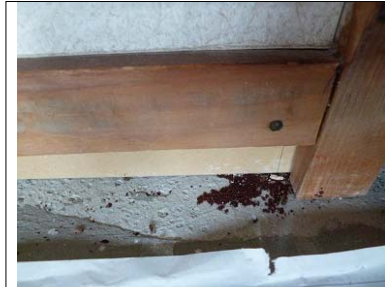
No. 4 押入れ左側 小壁下糞害状況
