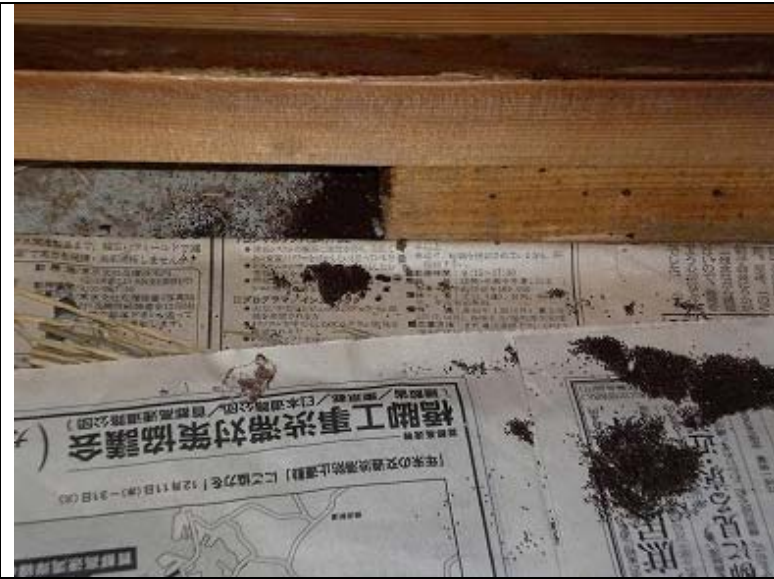
No. 7 リビング側壁下 糞害状況
