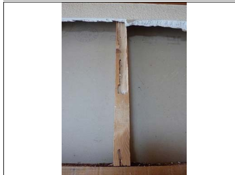
No. 11 リビング側壁 下地・胴縁 被害状況 1
