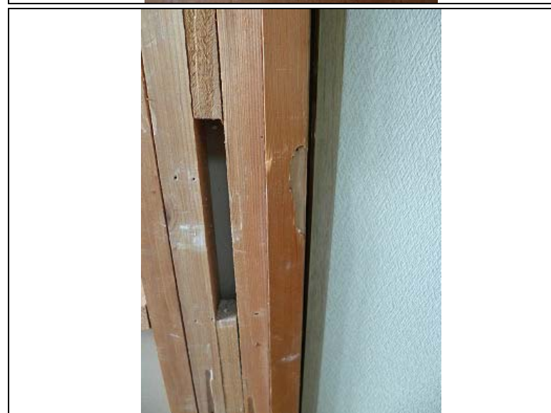
No. 12 リビング側壁 下地・胴縁 被害状況 2
